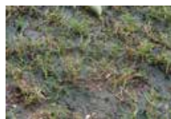
2014年。排水不良で、歩くと滑る危険な状態の公園内の芝生。
